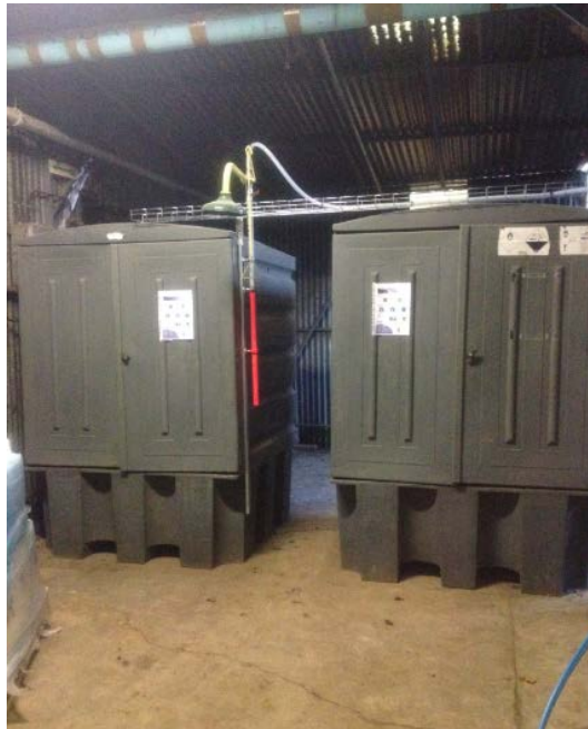
Photo 17. Stockage des cuves de peroxyde d'hydrogène
