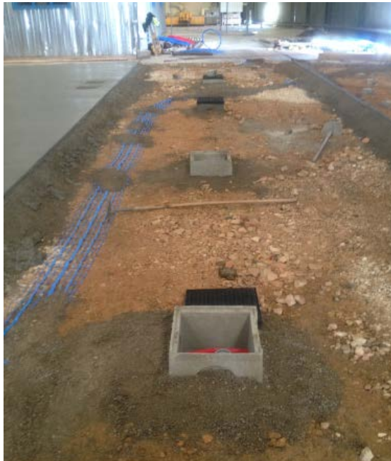
Photo 15. Zone ancienne fosse : mise en place du traitement des eaux souterraines, installation des aiguilles d'injections Ai1 à Ai4
