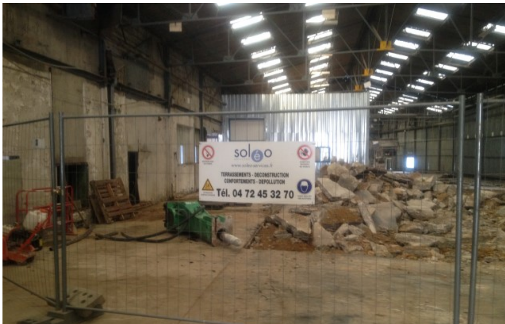
Photo 2. Sécurisation de la zone de travail par des barrières heras (2m de haut)
