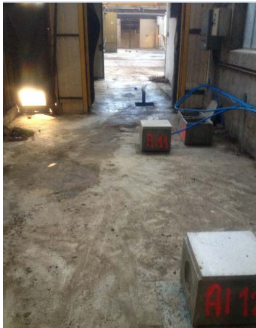
Photo 16. Zone chaufferie : mise en place du traitement des eaux souterraines, installation des aiguilles d'injections Ai10 à Ai12
